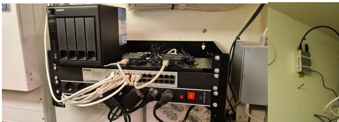
Figur A4: Ny organisation av hårdvara med nytt rack samt nätverksswitch.
