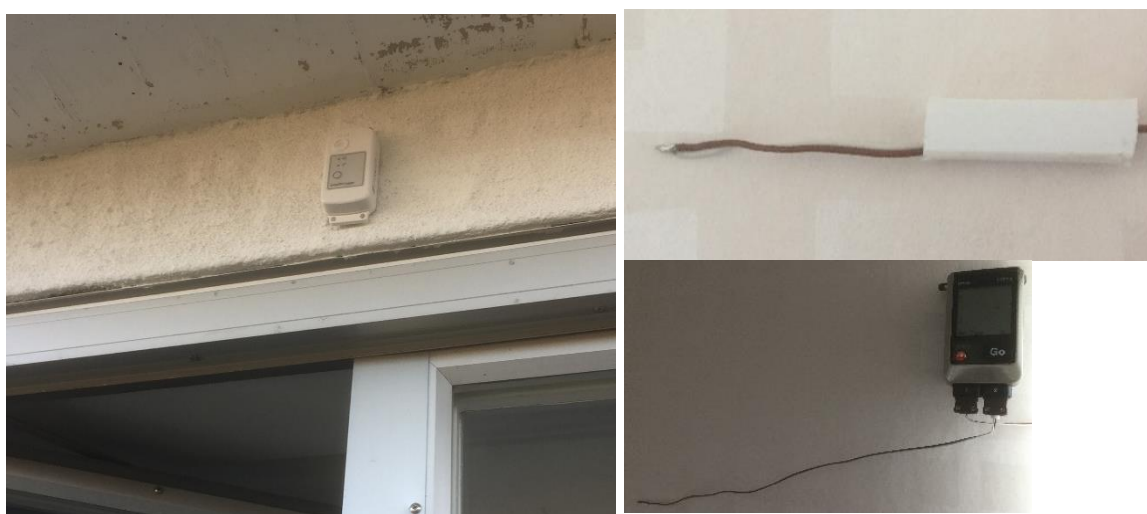
Figur 8: Bilder på givare för mätningar på ytterväggar, Uppsala. Från vänster: T & RF sensor för uteluft, termoelement på insidan.
