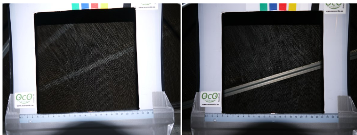
Figur 3.2: Bilder för åskådliggörande av skillnad före (vänster) och efter (höger) rengöring av aggregat. Uppmätt skillnad i temperaturverkningsgrad: 0%, tryckfall: 11 Pa.
