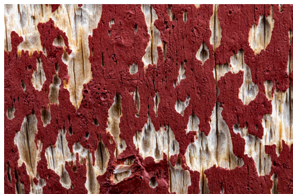
Figur B6-4. Skador på nordostvägg genererade av små-sten vid vindstyrkor på 60 m/s.
