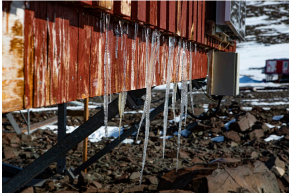
Figur B6-5. Istappar från smältande drivsnö i vägg.
