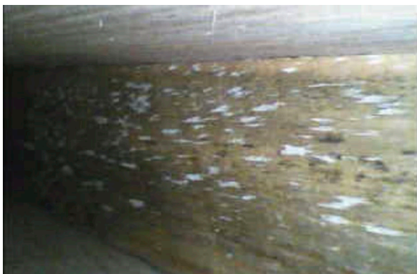
Figur B6-7. Sannolik mikrobiell påväxt på regler i luftspalt i nordostväggen.
