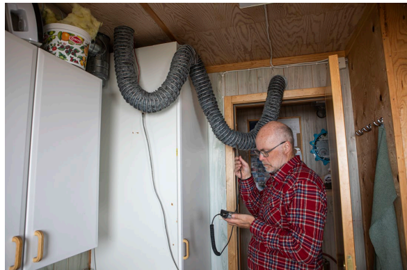
Figur B6-10. Tillfällig inkoppling av ursprungligt ventilationssystem.
