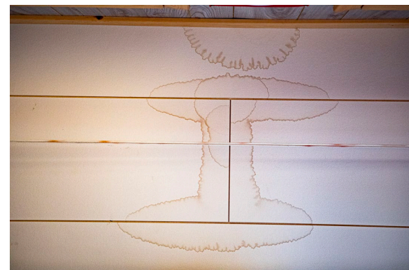
Figur B6-8. Spår av fuktgenomträngning på takpanel i innertaket.
