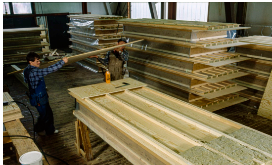
Figur B6-2. Tillverkning av väggelement med luftspalt. Tätning mot drivsnö syns nederst till höger i bild
