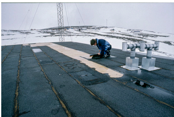
Figur B6-3. Skadad takpapp efter första vintersäsongen 1989.
