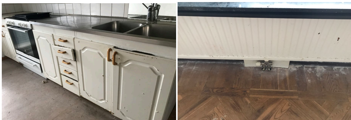
Figur 2. Hög slitage på kök och parkettgolv i en lägenhet som haft väldigt hög boendetetthet.
