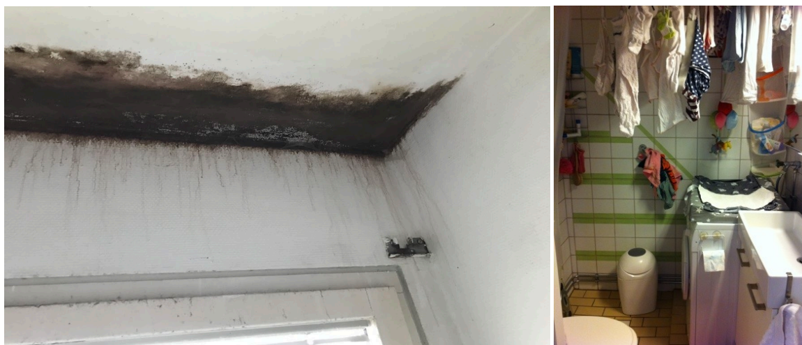
Figur 1. Mögelpåväxt i vägg-takvinkel i badrum i en lägenhet som haft väldigt hög boendetäthet vilket kan bero på frekvent duschande men även andra fuktalstrande aktiviteter såsom torkning av tvätt.
